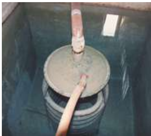
TANQUE CON AGUA DONDE SE SUMERGE EL SERPENTÍN
