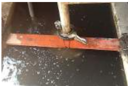
Tanque con agua donde se sumerge el serpentín.
