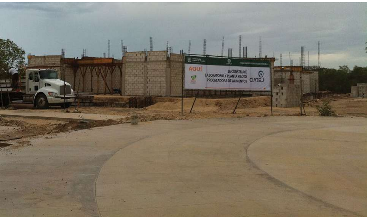
Figura 4. Avances de obra de la Planta Piloto de Alimentos y los Laboratorios de la Unidad Sureste del CIATEJ
